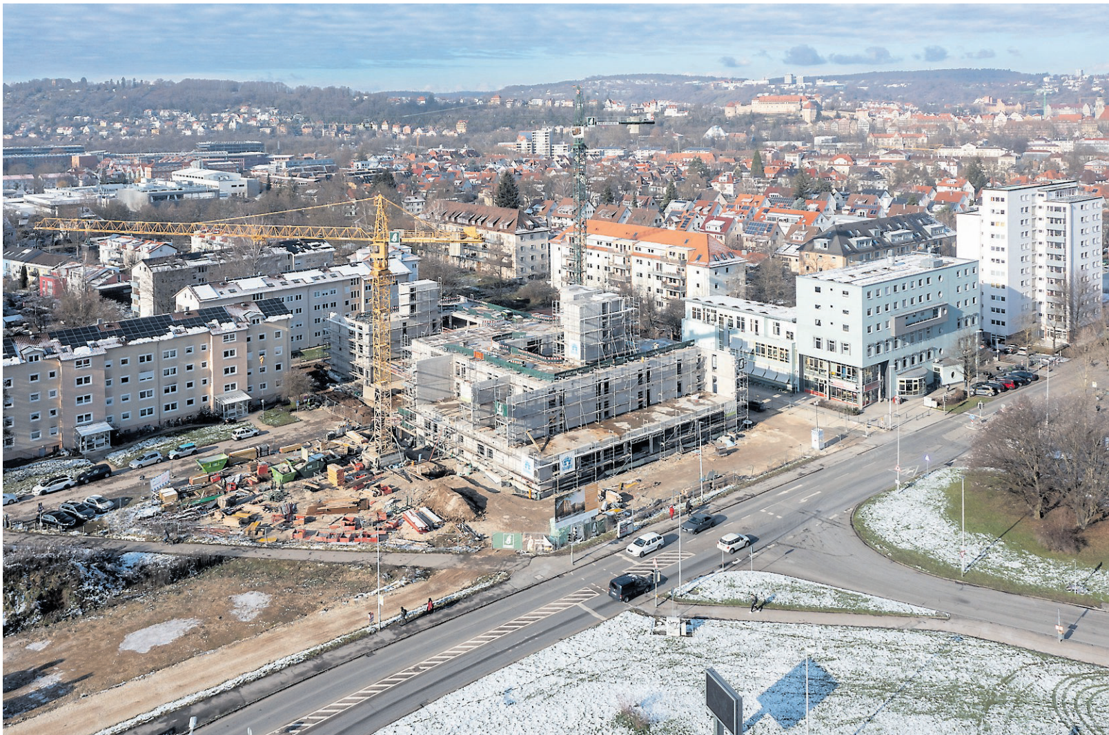
Am Hechinger Eck entsteht zur Zeit die Mensa für die Grundschule und ein Seniorenheim. Auf dem Baufeld links daneben ist für einen Gebäude- teil nun die Stadt eingesprungen. Bild: Ulrich Metz
